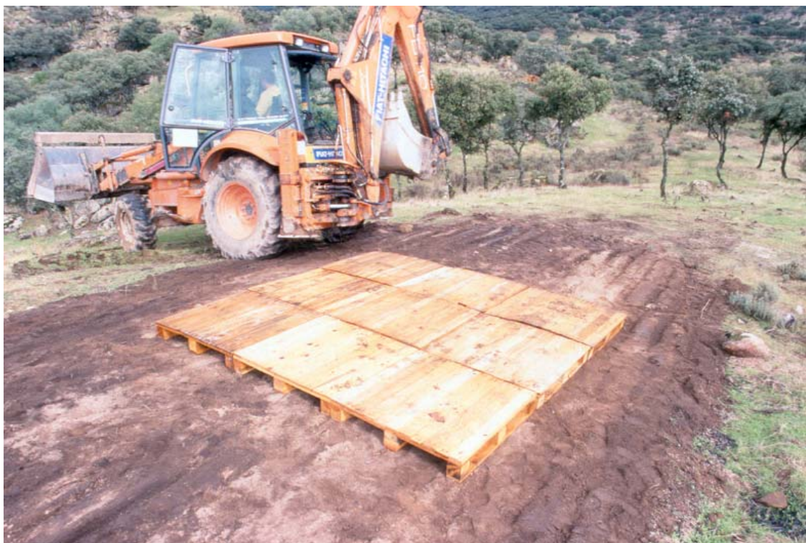
Construcción de un refugio de palets (3 x 3) del tipo totalmente cerrado y reforzado en la zona central.
